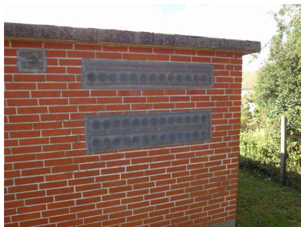
Insektnet for udluftning til filtre.
